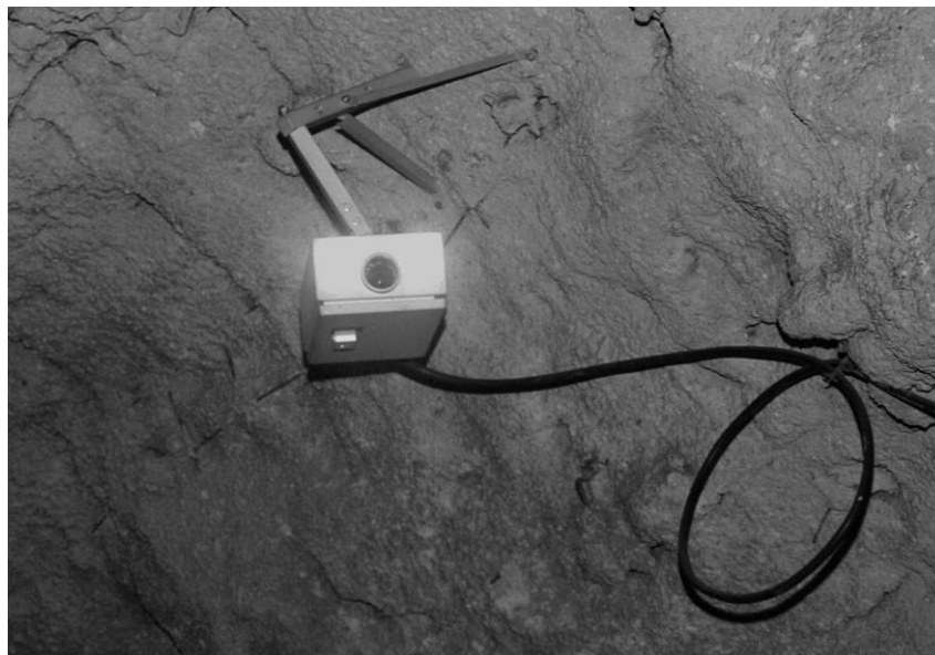
Рис. 3 Установка БВК-РН в горных выработках
